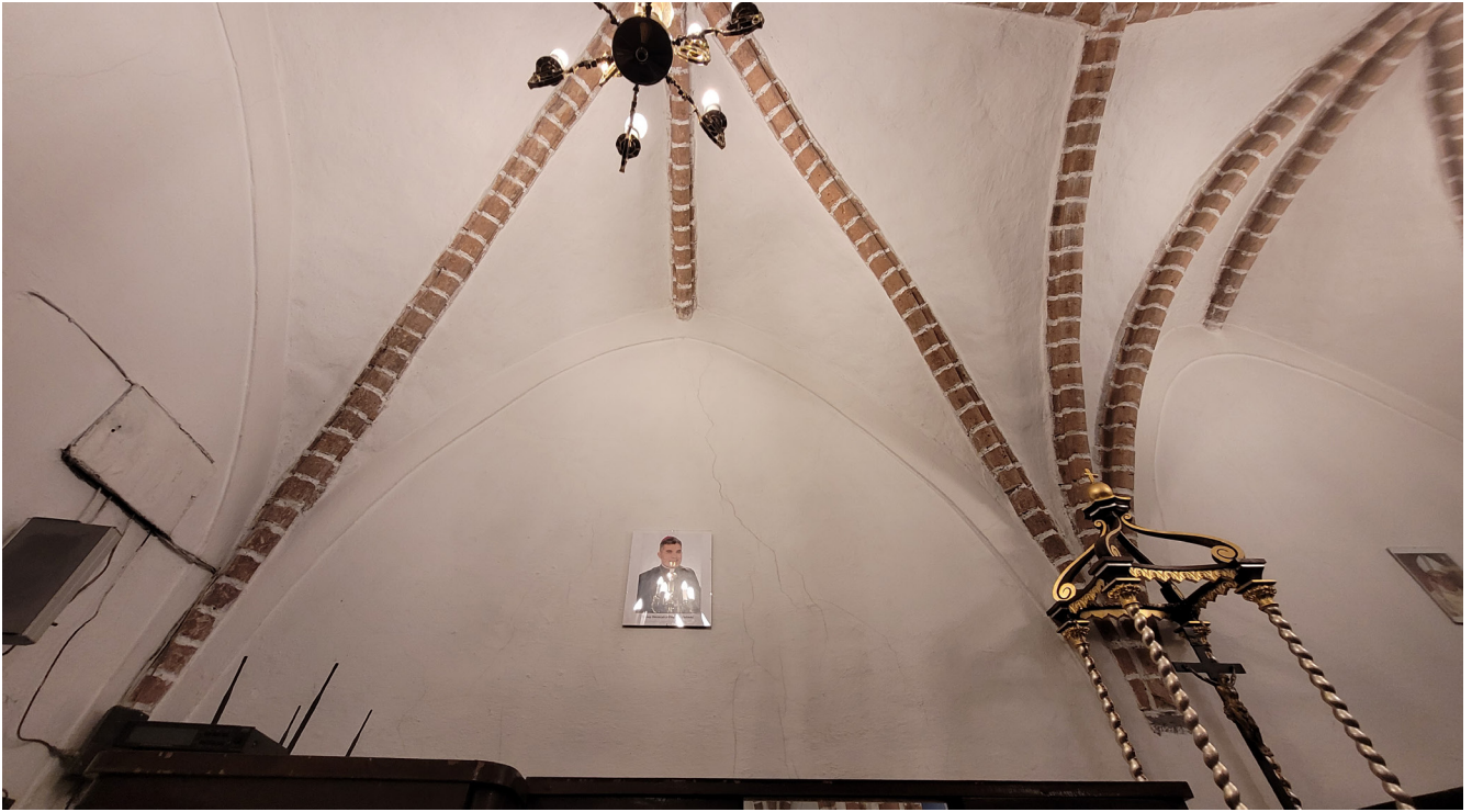
fot. 39. Kościół pw. Matki Bożej Częstochowskiej w Darłowie. Kaplica Grobowa. Zakrystia - sklepienie palmowe.
