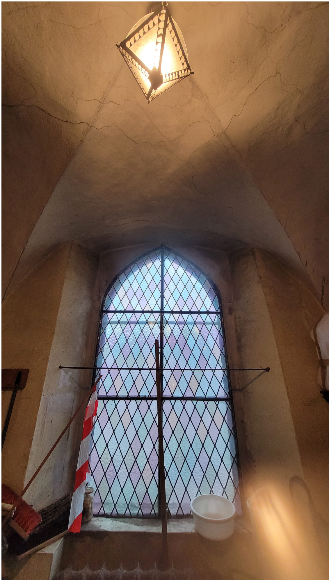
fot. 21. Kościół pw. Matki Bożej Częstochowskiej w Darłowie. Skarbczyk widok w kierunku północnym - okno do wymiany.
