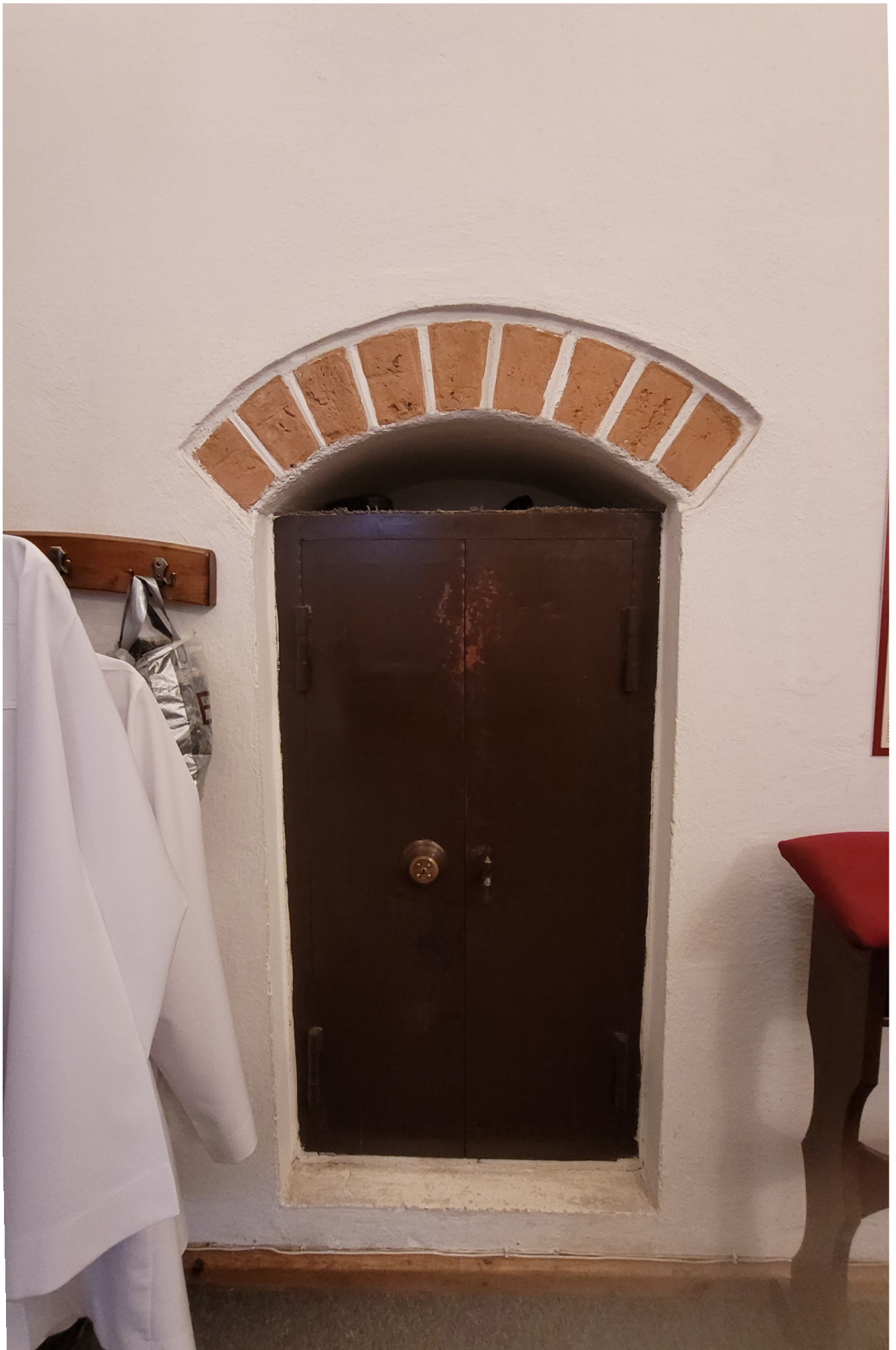
fot. 41. Kościół pw. Matki Bożej Częstochowskiej w Darłowie. Kaplica Grobowa. Zakrystia - wnęka w której osadzono sejf.
