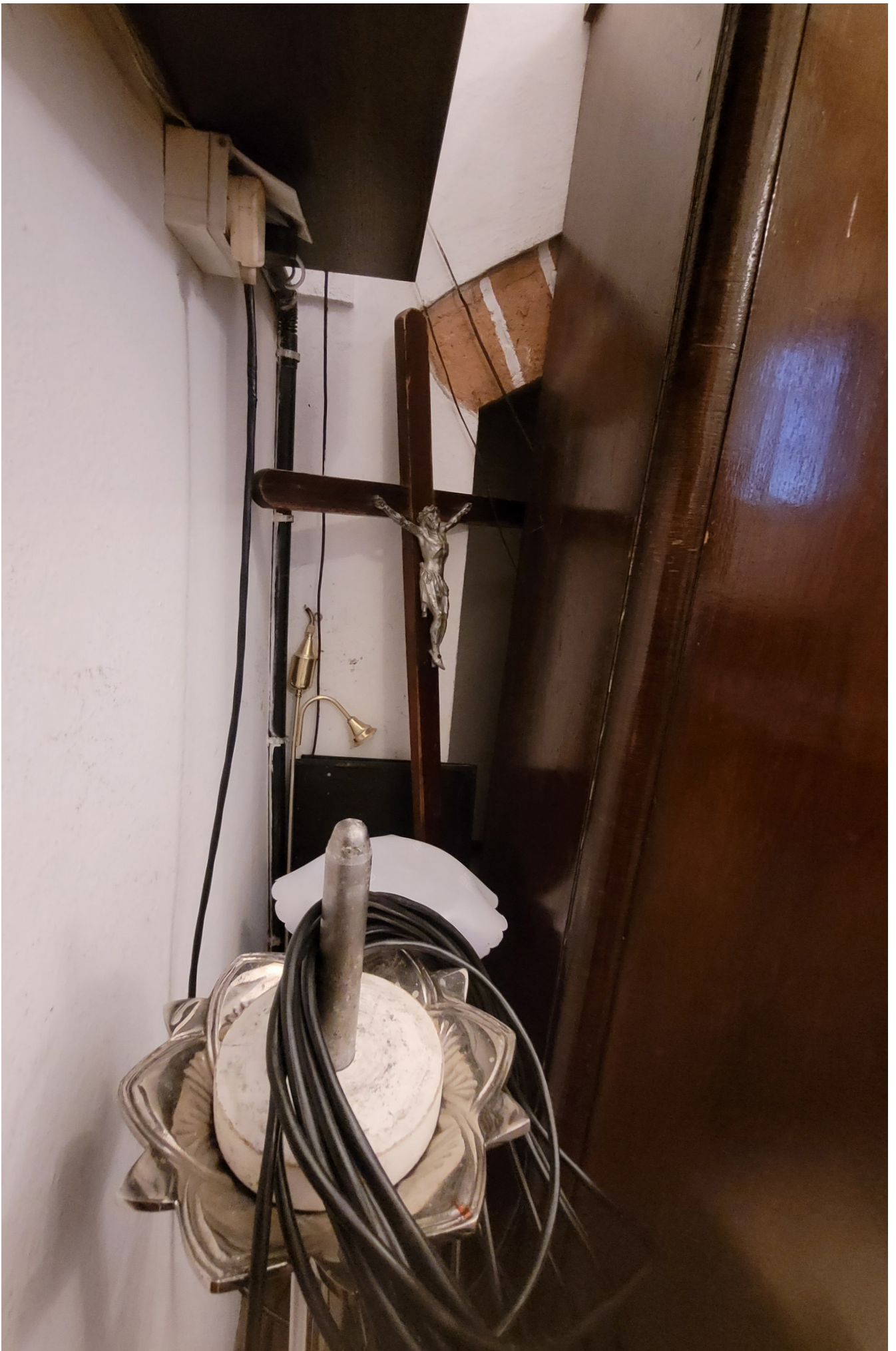
fot. 43. Kościół pw. Matki Bożej Częstochowskiej w Darłowie. Kaplica Grobowa. Zakrystia - wnęka w ścianie zachodniej zakrystii.
