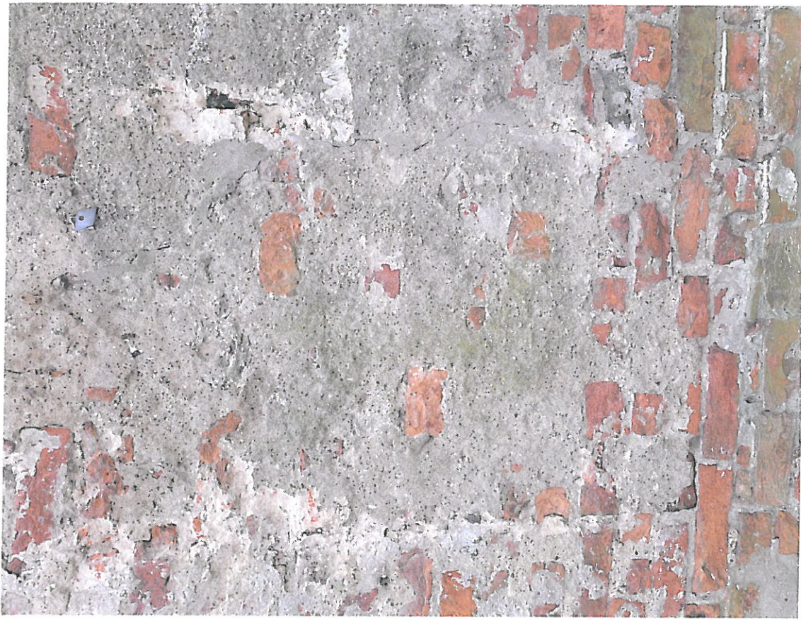
Fot. 8. Darłowo – kościół pw. Matki Bożej Częstochowskiej, elewacja północna. Na wschód od zamurowanego otworu klatki schodowej przy zakrytych zachowały się skute cegły. Są to ślady po pionowo dochodzącym murze.
