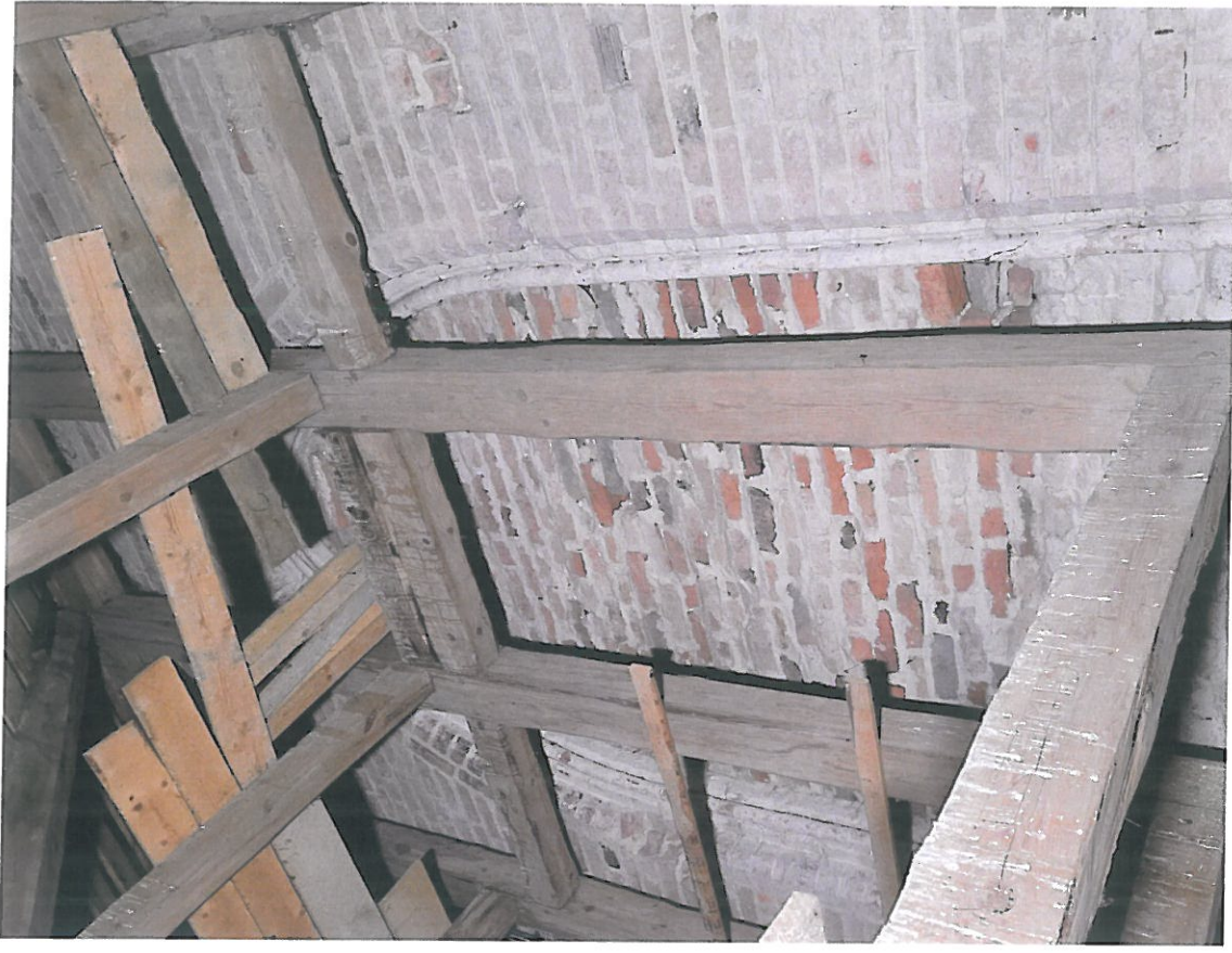
Fot. 20. Darłowo – kościół pw. Matki Bożej Częstochowskiej, poddasze zakrystii. Na ścianie północnej prezbiterium widoczne jest zamurowanie wysmukłego gotyckiego okna, zlikwidowanego podczas podwyższania zakrystii w XVI w.
